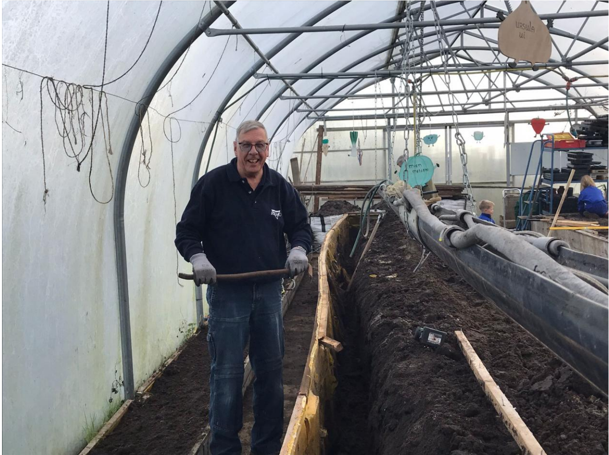
Hier zie je mooi hoe krom de oude, houten wand was!
