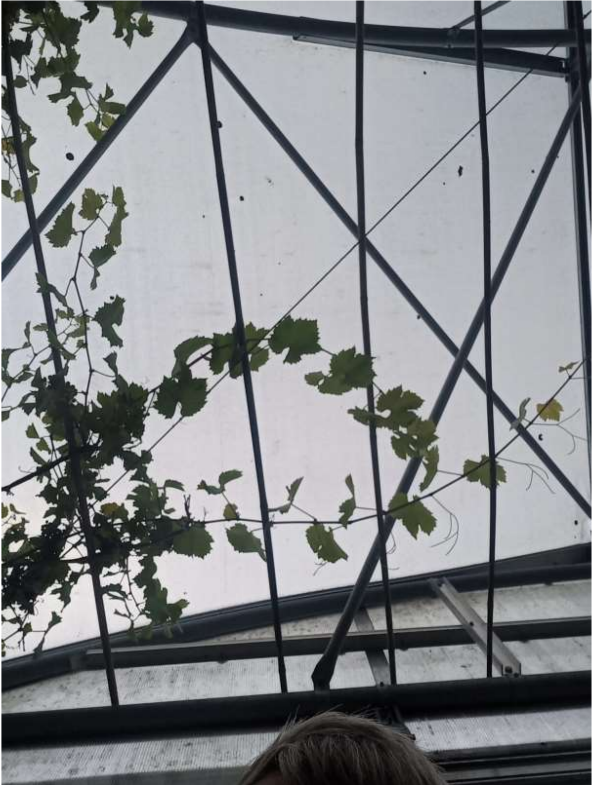
Dit is een foto van het dak van de kas, maar bovenin de druiven plant.
